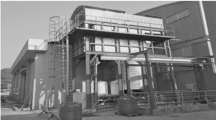
▲ Hình 4. Hệ thống xử lý xử lý nước sau tách bùn lắp đặt hoàn chỉnh
